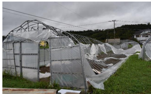
倒壊したビニールハウス
